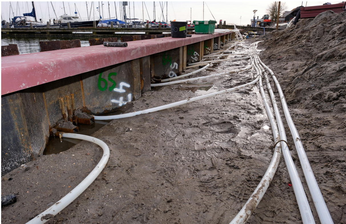
Figuur 10 Geïnstalleerde energie damwand in Enkhuizen
